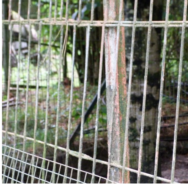
Figura 5.2, figura 5.3, figura 5.4 y figura 5.5. Vallas rotas, en mal estado y/o oxidadas, de instalaciones diferentes.
